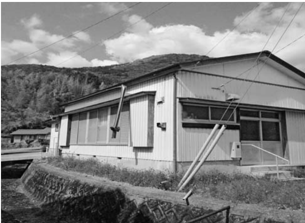
大雪で雨どいの破損被害(父原集会所)
