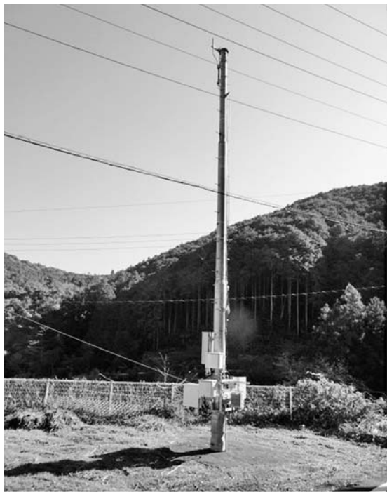
柱谷地域に基地局が設置された
