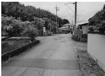
役場から西の駅前江尻線の痛んだ路面
