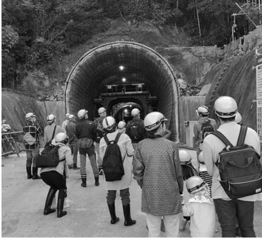
仁淀ブルー体験博において人気のあった「今年が最後！工事中の日下川新規放水路を見学！」
