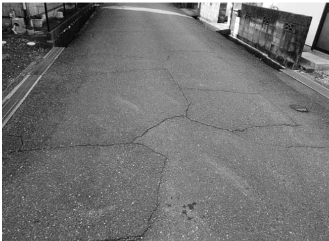
望ヶ丘のひび割れの入った道路
