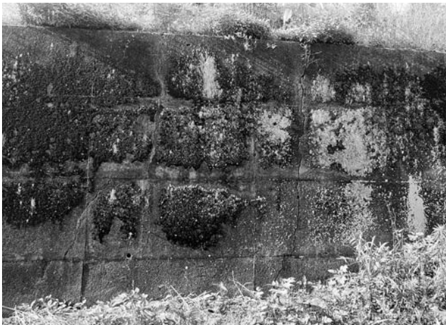
望ヶ丘団地のひび割れの入った擁壁
