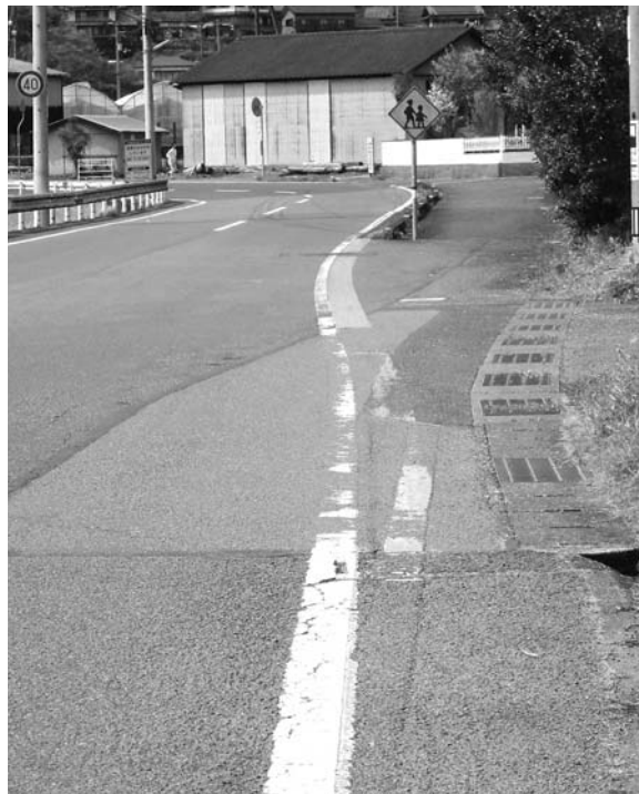
グリーンベルト塗りなおしが必要な県道（岩目地）
