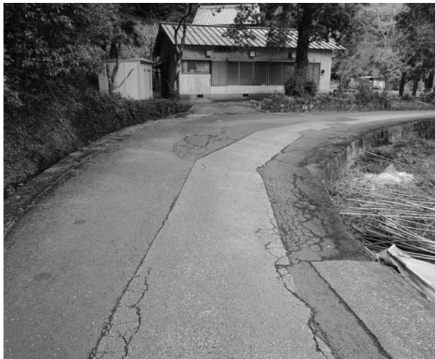
村道宮谷鹿児線未整備区間 上段：沖名県道付近 下段：中間点付近
