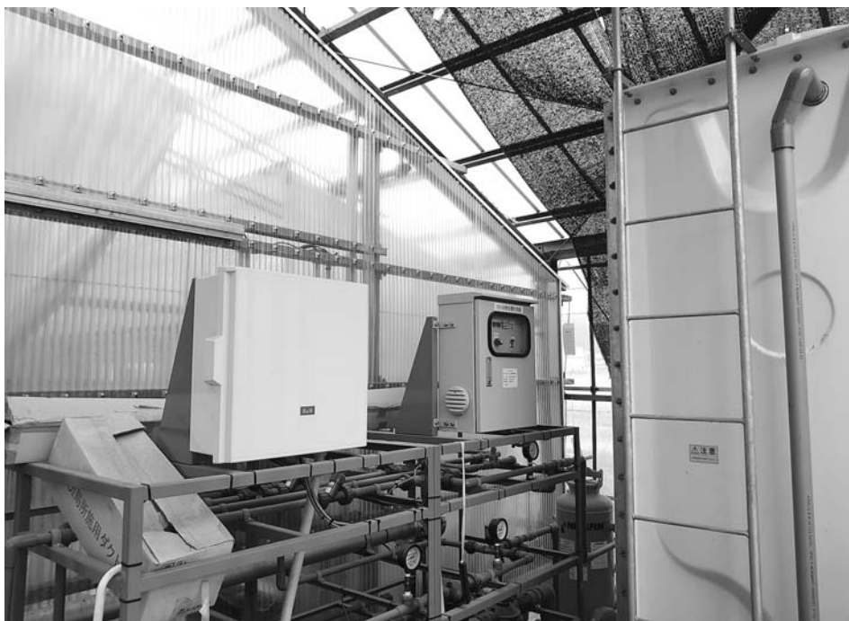
災害で停電になると、全ハウスに養液を送ることができない。1日止まっただけで多大な被害となる
