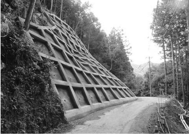
通行可能となった鴨地谷口地区の山崩れ現場
