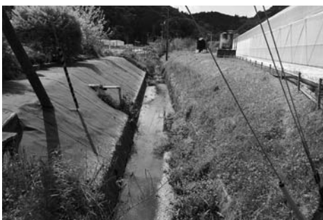
土砂が堆積する父原谷川
