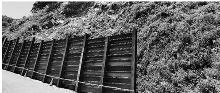
妹背の法面崩壊現場
