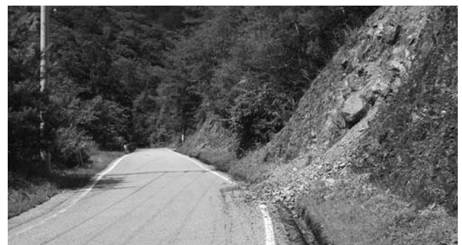
機能していない側溝
