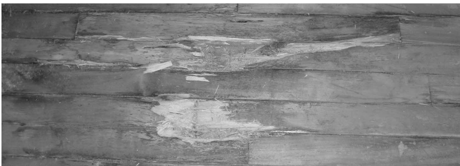
雨漏りの体育館床
