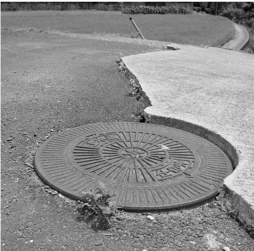
地割れがひどい大橋地区
