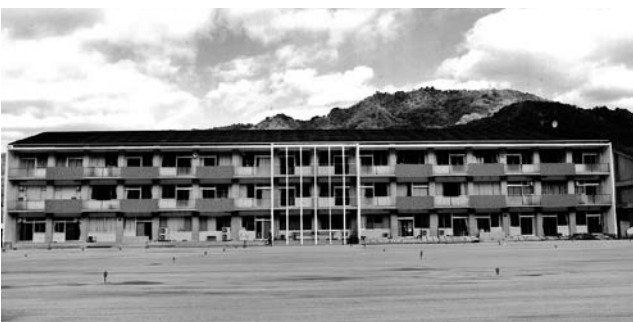
日高中学校太陽光発電パネル(屋根の部分)
