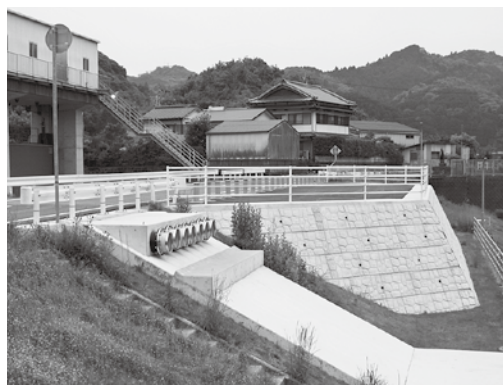
神母樋門排水ポンプ車配置ヤード
