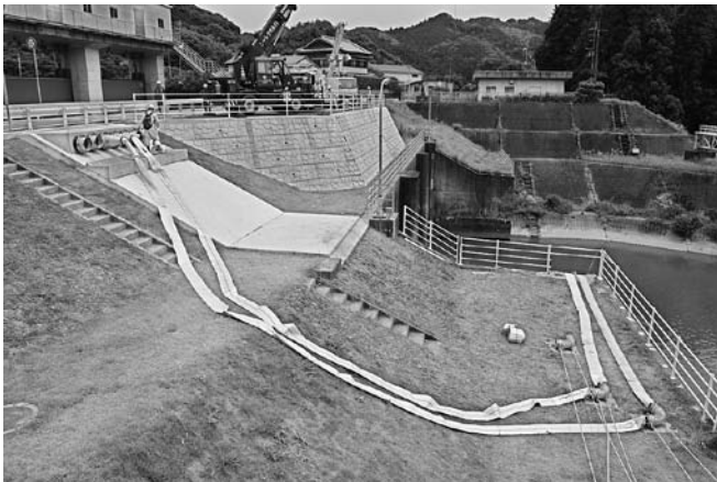
仮設の揚水用配管(上流側)
