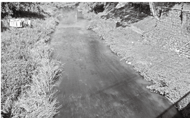
洗掘が心配される日下橋付近
