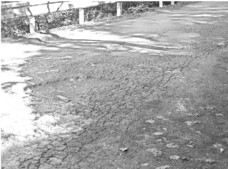
村道の舗装破損
