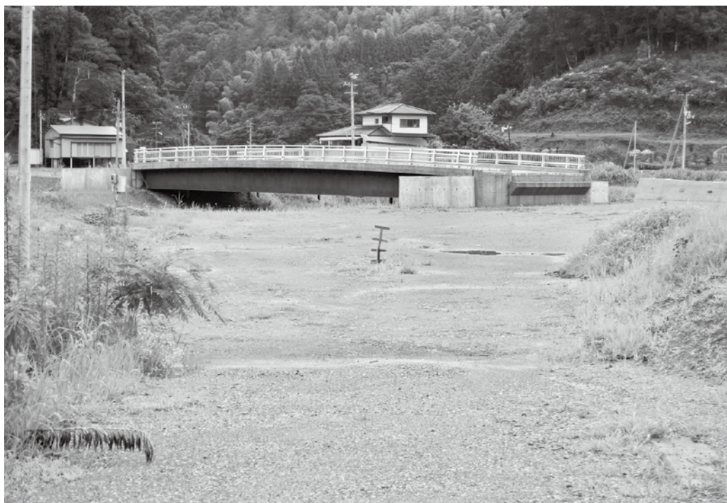
工事が中断している八幡前橋
