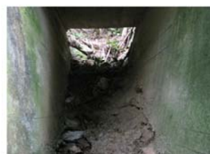
0021 宮ノ谷 1 号橋 下部工の変状(有)
