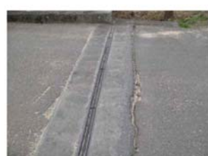
0046 鹿見橋 路面の凹凸(有)
