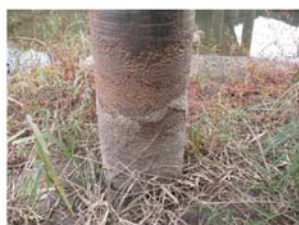
0091 名越屋沈下橋 腐食 e
