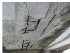
0821 柏井西橋 鉄筋露出(有)
