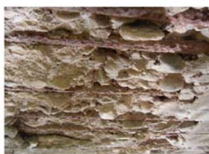
1211 伊保橋 鉄筋露出(有)
