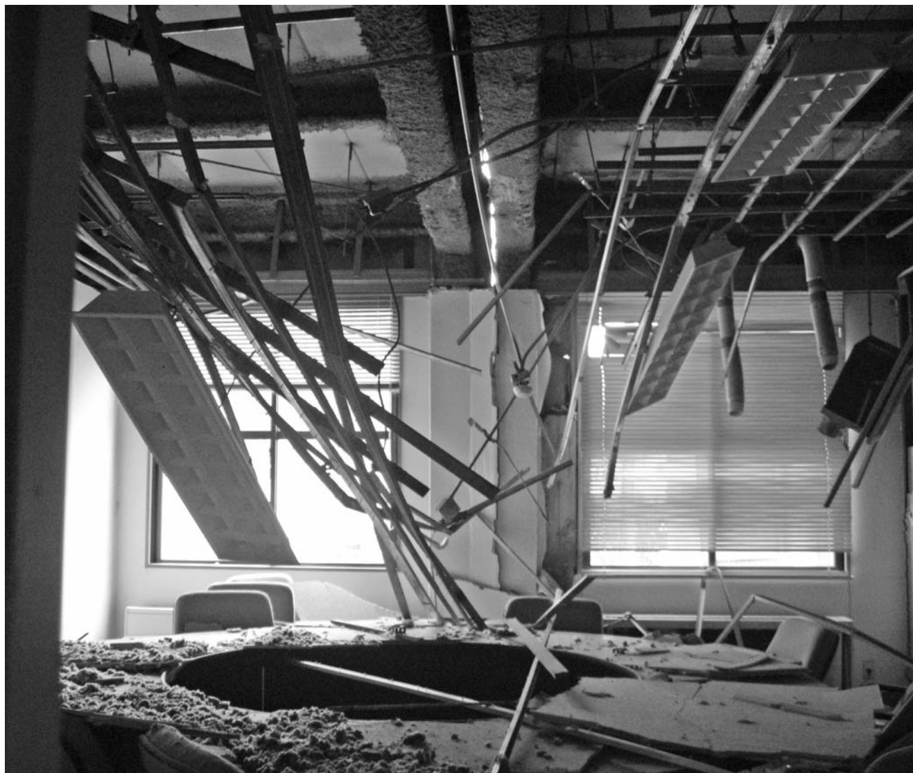
熊本地震被災状況 益城町議会議事堂小会議室
