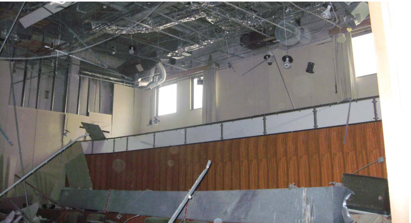
熊本地震被災状況 益城町議会議事堂傍聴席付近
